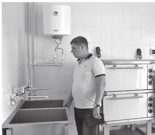
Заместитель начальника отдела жилищно-коммунального хозяйства, архитектуры, градостроительства Администрации округа Артем Душенко проверил смонтированное оборудование в пищеблоке детского сада
