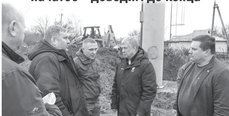
Алексей Русских на объекте восстановления: установка новой водонапорной башни Рожновского в Успенке
